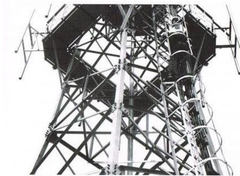
Gambar 3.25 Elemen siku tunggal pada tower radio ( www.transmitter-tower.cn )
