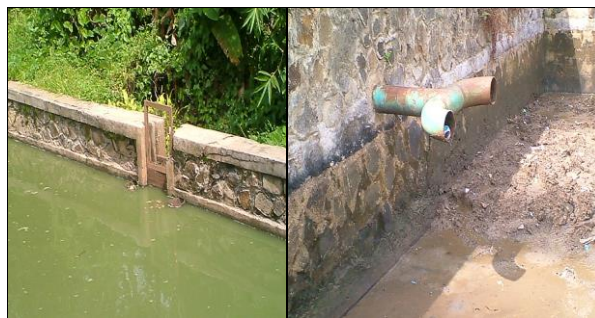
Gambar 85. Pipa Pemasukan dan Pengeluaran Air
