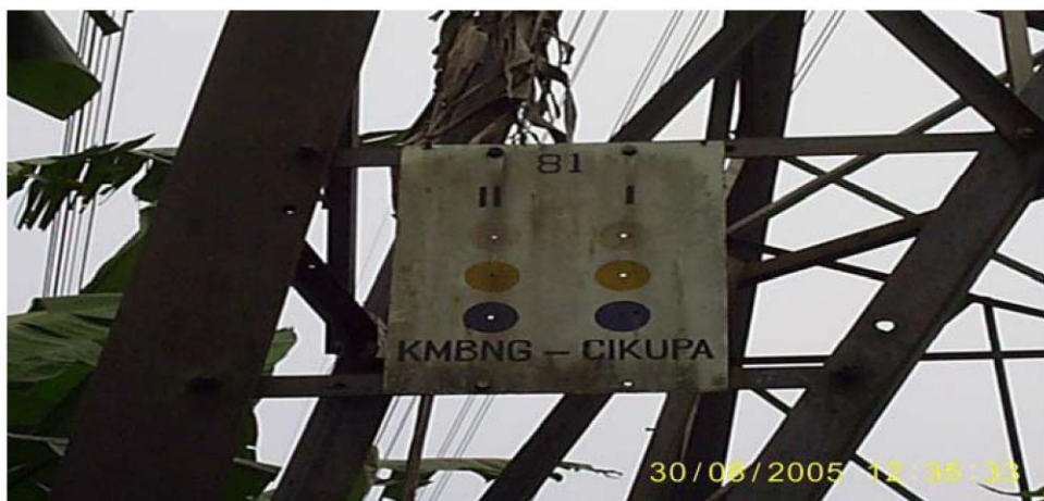
Gambar 9. 3 Kerusakan (abnormality peralatan) pada menara
