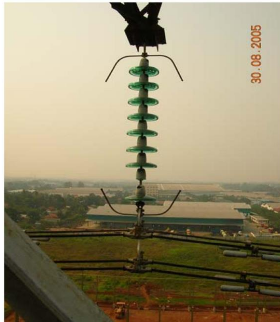
Gambar 9. 4 Kerusakan pada isolator gantung
