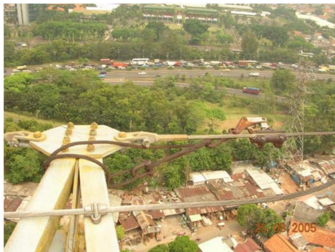
Gambar 9. 5 Kerusakan pada kawat pentanahan
