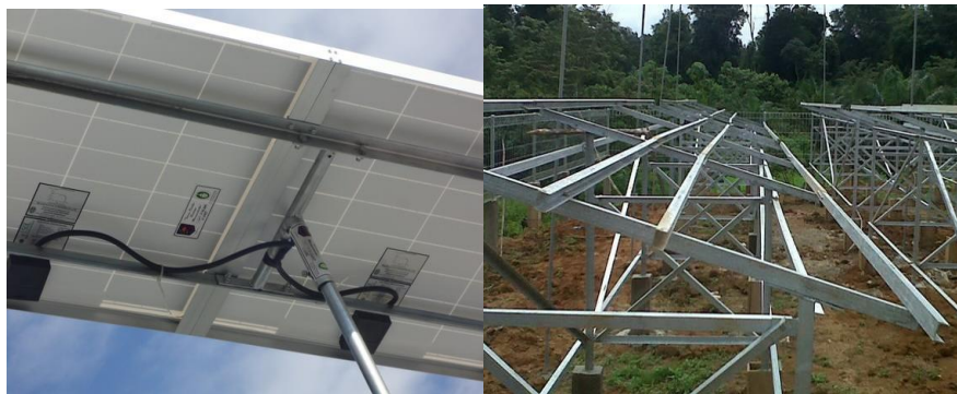
Penyangga sistem PLTS
