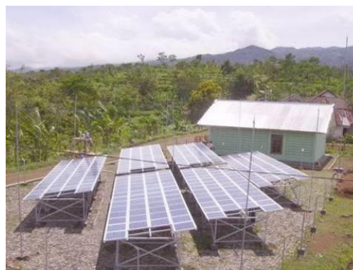
Gambar 7. 2 Sistem Pembangkit Listrik Tenaga Surya
