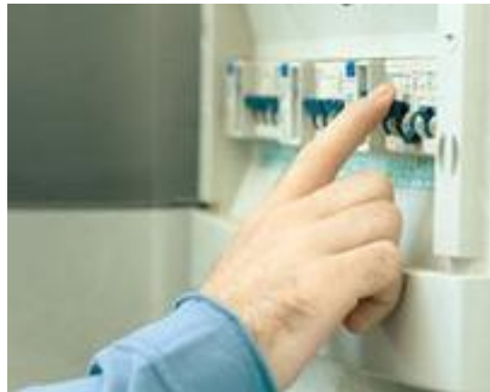
Gambar 4. 32 Matikan sumber listrik melalui sakelar/MCB ( Switch ON-OFF ) dengan menurunkan posisi handelnya
