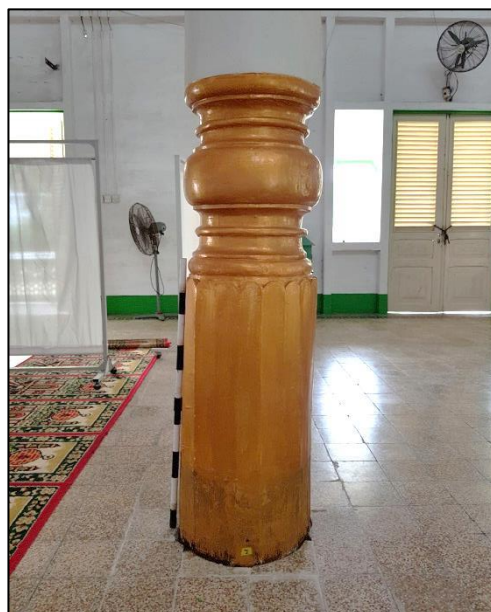
Foto III-21 Kondisi Kolom TU. F.18 dari sisi utara (Dok. BPCB Kalimantan Timur. 2020)
