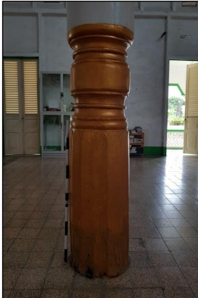
Foto III-29 Kondisi Kolom TU. F.9 dari sisi utara (Dok. BPCB Kalimantan Timur. 2020)
