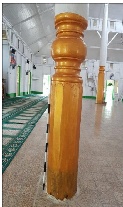
Foto III-27 Kondisi kolom TU. F. 37 dari sisi selatan (Dok. BPCB Kalimantan Timur. 2020)
