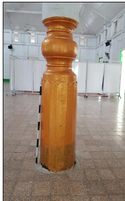
Foto III-28 Kondisi Kolom TU. F.28 dari sisi barat (Dok. BPCB Kalimantan Timur. 2020)
