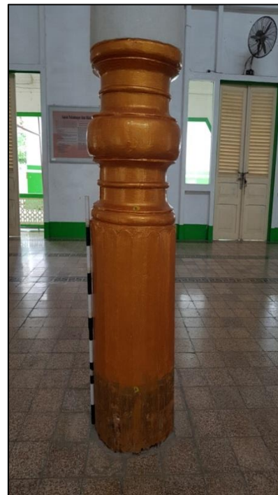
Foto III-23 Kondisi Kolom TU. a. 9 dari sisi barat (Dok. BPCB Kalimantan Timur. 2020)
