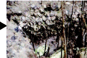
Foto Permukaan bunker dipenuhi sedimentasi kerang dan ditumbuhi lumut
