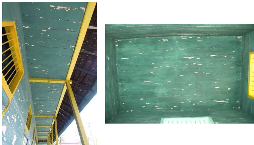
Foto 2.13 Kondisi Plafon Rumah Penjara Sanga-Sanga (Dok. BPCB Kalimantan Timur 2019)
