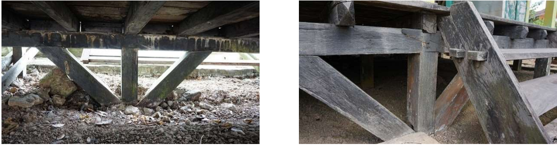
Foto 2.5 Kondisi Tiang Sokong (Dok. BPCB Kalimantan Timur 2019)
