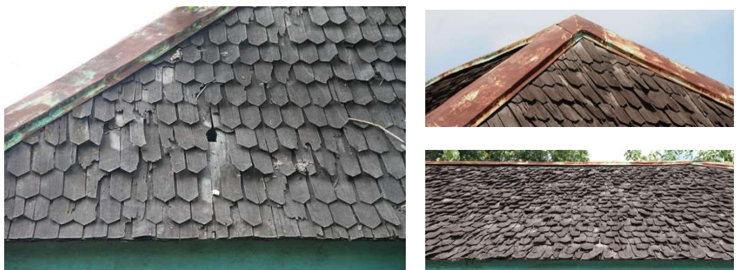
Foto 2.15 Kondisi Atap Rumah Penjara Sanga-Sanga (Dok. BPCB Kalimantan Timur 2019)
