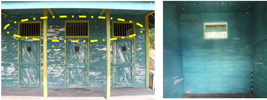
Foto 2.11 Kondisi Ventilasi Rumah Penjara Sanga-Sanga (Dok. BPCB Kalimantan Timur 2019)
