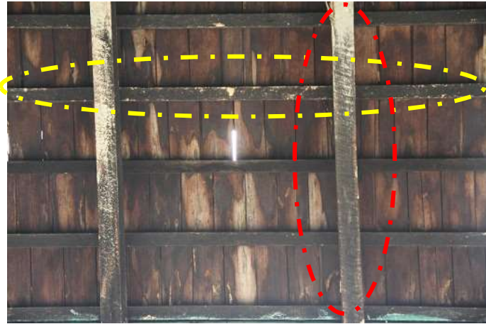
Foto 2.14 Kondisi Kasau dan Reng Rumah Penjara Sanga-sanga (Dok. BPCB Kalimantan Timur 2019)
