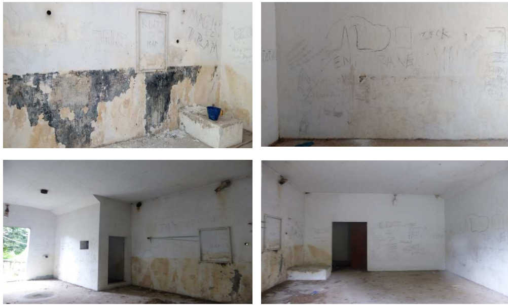
Foto 3.5 Kondisi dalam bunker Gardu Listrik sebelum dilakukan pembersihan dan pengecatan
