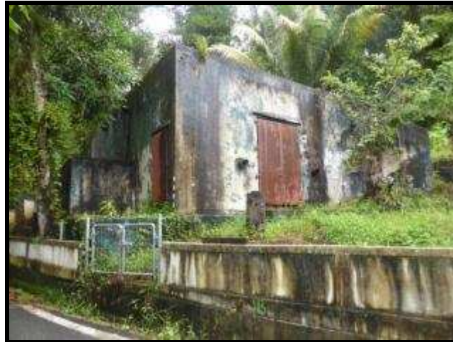
Foto 2.2 Gardu Listrik Juata Laut
