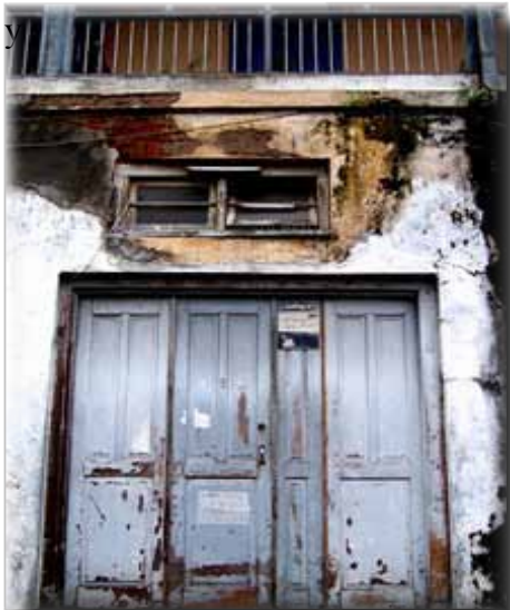
Tampak depan salah satu rumah toko yang kondisinya telah rusak
