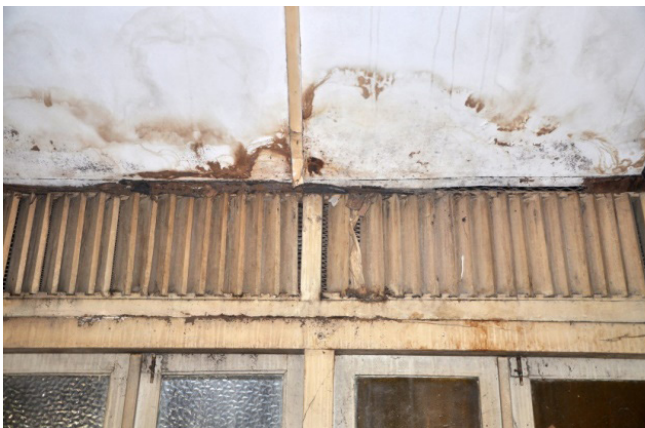
Kusen jendela yang mengalami kerusakan (Foto: dok. BPCB DIY)
