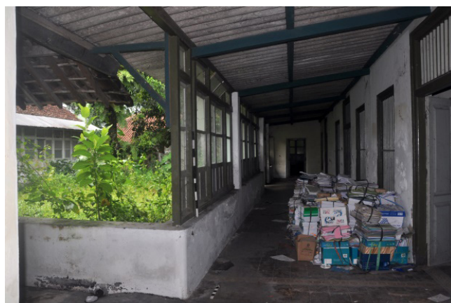
Kondisi atap semua bangunan dari bahan asbes (Foto: dok. BPCB DIY)
