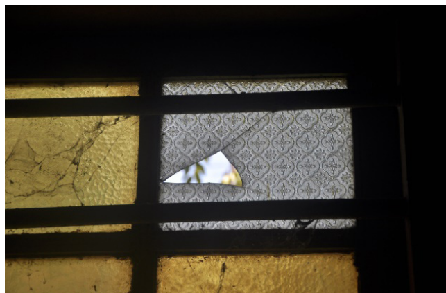
Kaca pada jendela yang pecah (Foto: dok. BPCB DIY)
