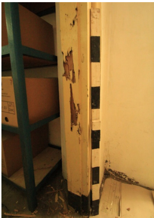
Kerusakan pada kusen jendela dan pintu (Foto: dok. BPCB DIY)
