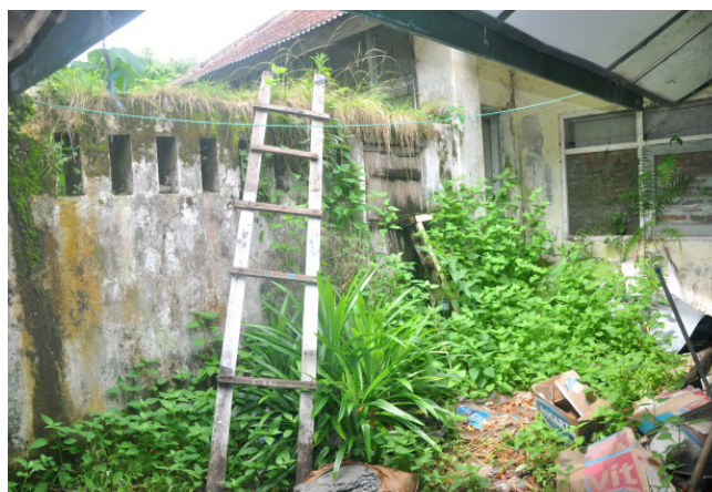
Kondisi tembok bagian belakang (Foto: dok. BPCB DIY)
