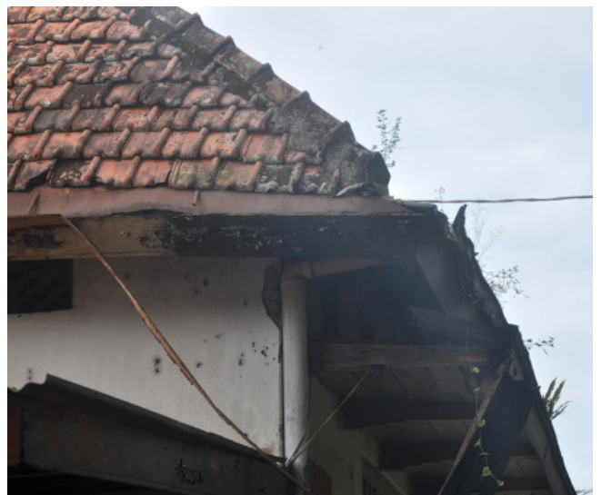
Kondisi talang yang rusak (Foto: dok. BPCB DIY)
