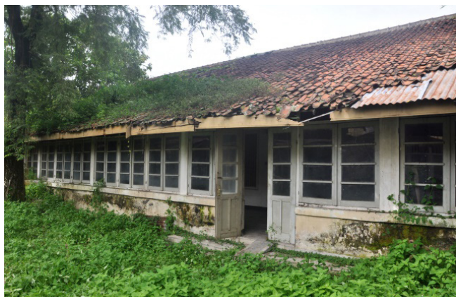
Kondisi atap bangunan (Foto: dok. BPCB DIY)
