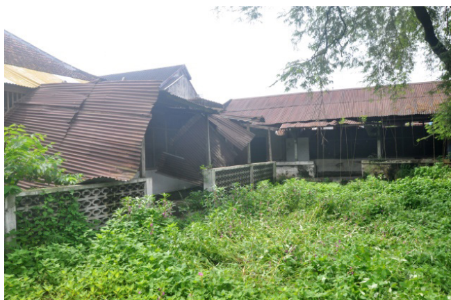
Kondisi teras yang ambrol (Foto: dok. BPCB DIY)
