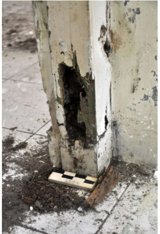
Kusen pintu yang mengalami kerusakan (Foto: dok. BPCB DIY)
