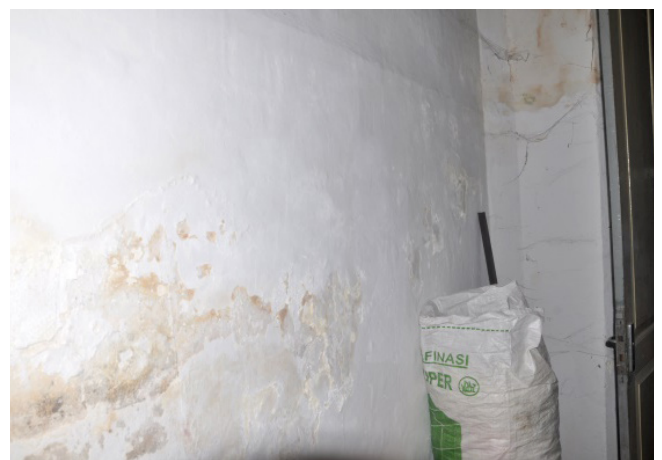
Plesteran yang mengelupas pada Bangunan A (Foto: dok. BPCB DIY)
