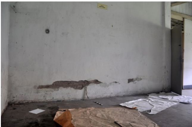
Plesteran yang mengelupas pada Bangunan C (Foto: dok. BPCB DIY)
