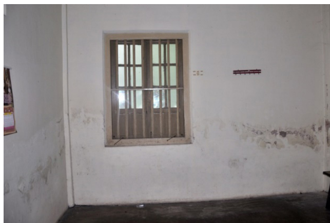
Plesteran yang mengelupas pada Bangunan B (Foto: dok. BPCB DIY)
