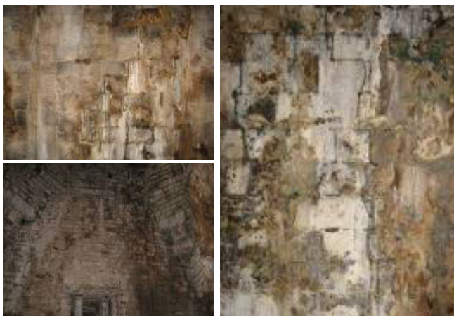
Gambar 4. Alur rengkahan vertikal pada dinding bilik dalam yang terjadi di bagian atap maupun bagian badan candi. (Foto: Dok. BPCB DIY)
