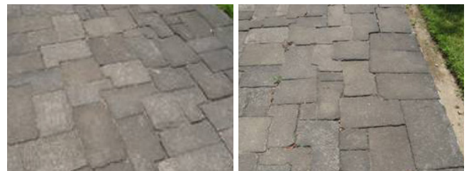
Gambar 5. Rengkahan pada lantai candi yang mengindikasikan terjadinya pergerakan struktur bangunan candi ke arah luar. (Foto: Dok. BPCB DIY)
