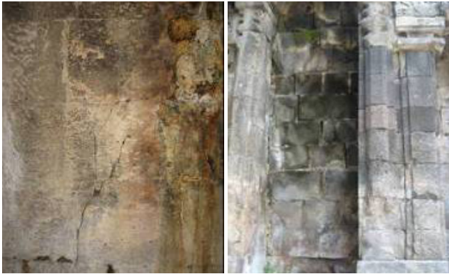
Gambar 6. Retak pada batu yang menyatu dengan alur rengkahan vertikal batuan pada dinding candi. (Foto: Dok. BPCB DIY)
