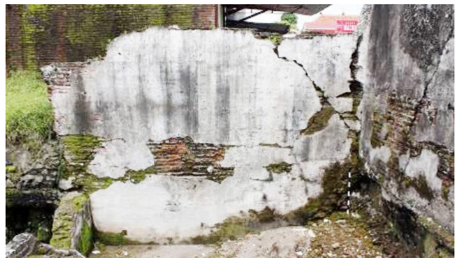
Gambar 9. Kondisi retakan struktur pada beteng barat laut. (Foto: Dok. BPCB DIY)
