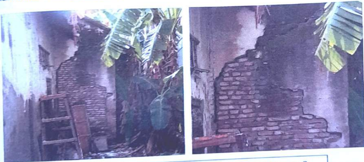
Dinding retak sisi timur bagian belakang bangunan no. 3
