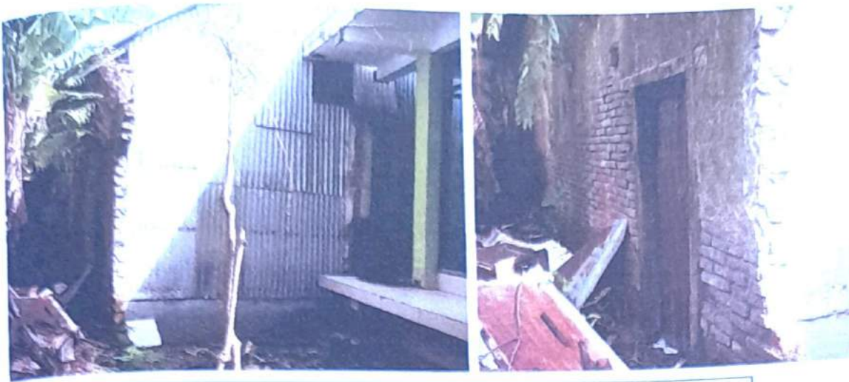
Bekas runtuh sisi barat bangunan no. 3
