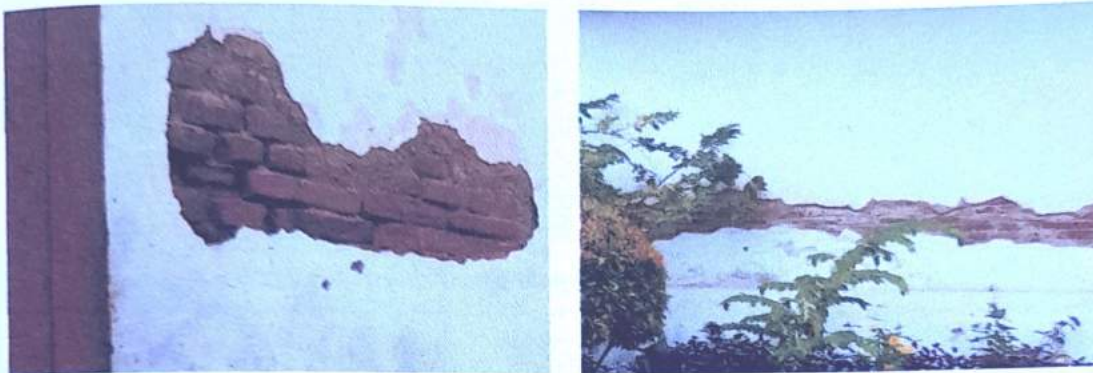
Pelapukan dinding sisi luar dalam pada keseluruhan bangunan
