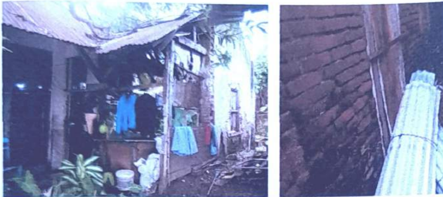
Runtuhan bangunan sisi belakang bangunan no. 2.2
